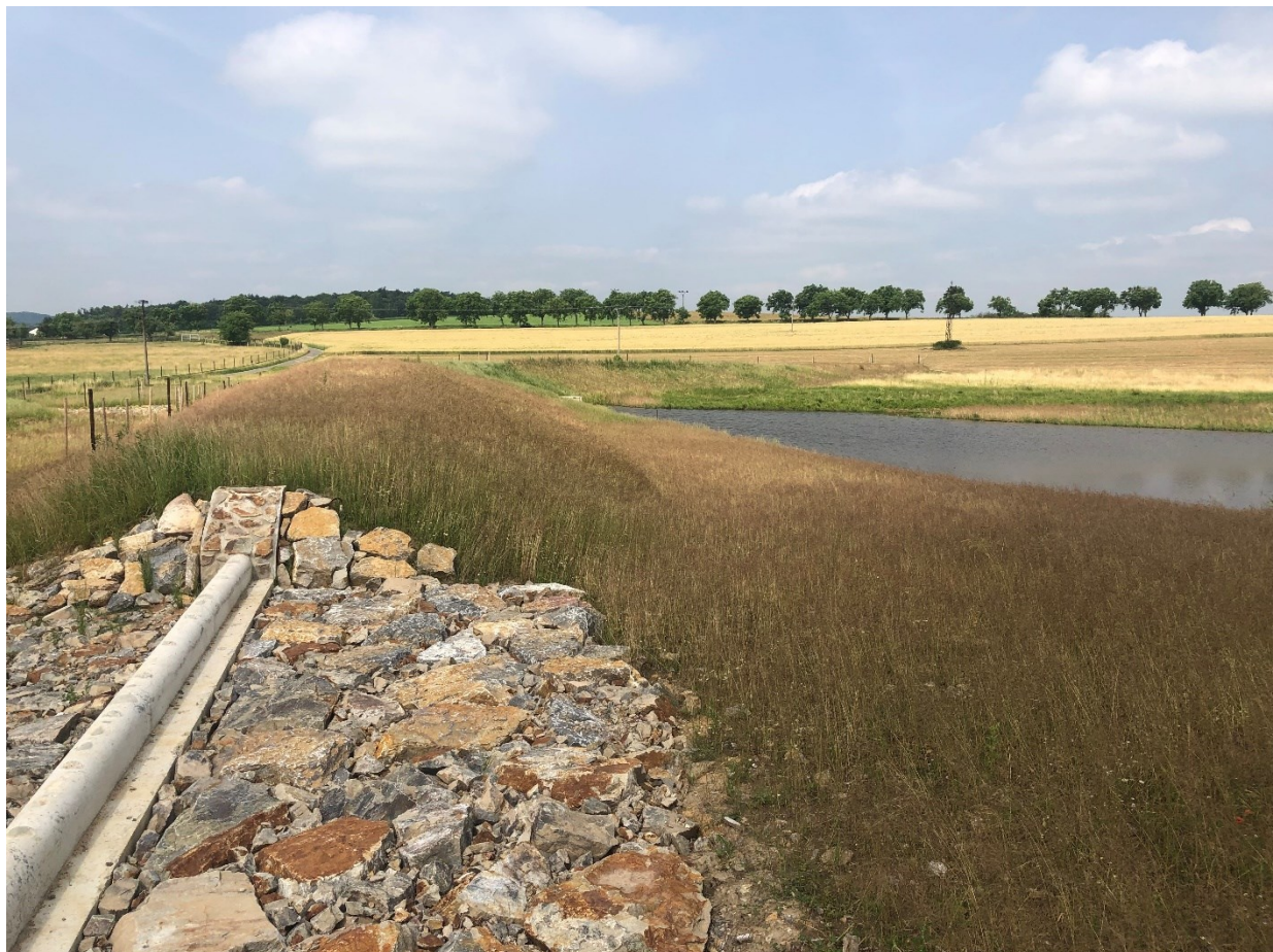
Výstavba suchého poldru v k.ú. Kublov (zachycení vody v krajině, ochrana obce před přívalovými srážkami)
